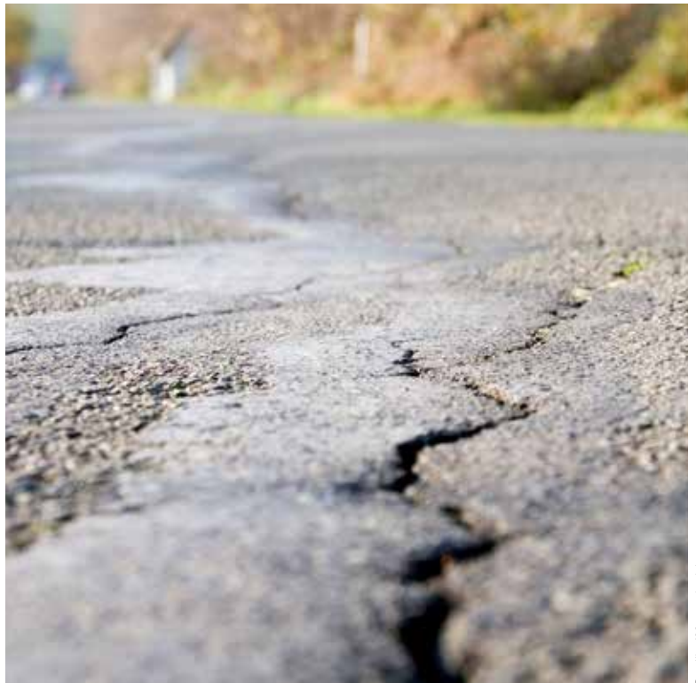
Rechtzeitige und kontinuierlich durchgeführte Rissanierungen können den Verfall der Straße um Jahre hinauszögern.
